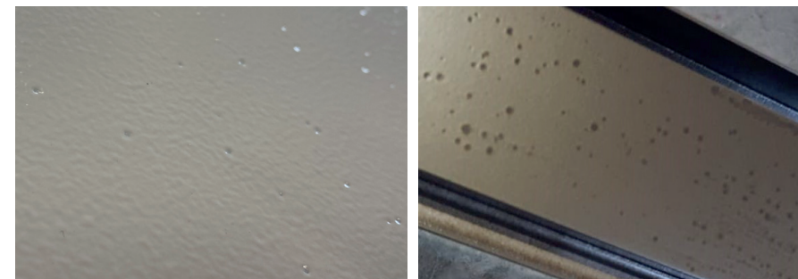
Widoczne podłoże powlekanej powierzchni z powodu kraterów
