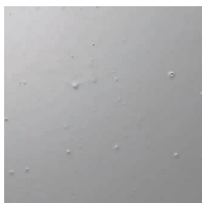
Nieprawidłowości powierzchni w wyniku gazowania
